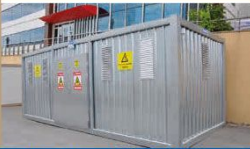
Tehlikeli Atık Konteyneri • Hazardous Waste Container
